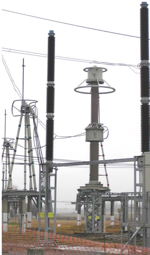
Рисунок 3. Опорні ізолятори ЕВ 750 кВ LTV 800E4 без дугогасильних камер.
