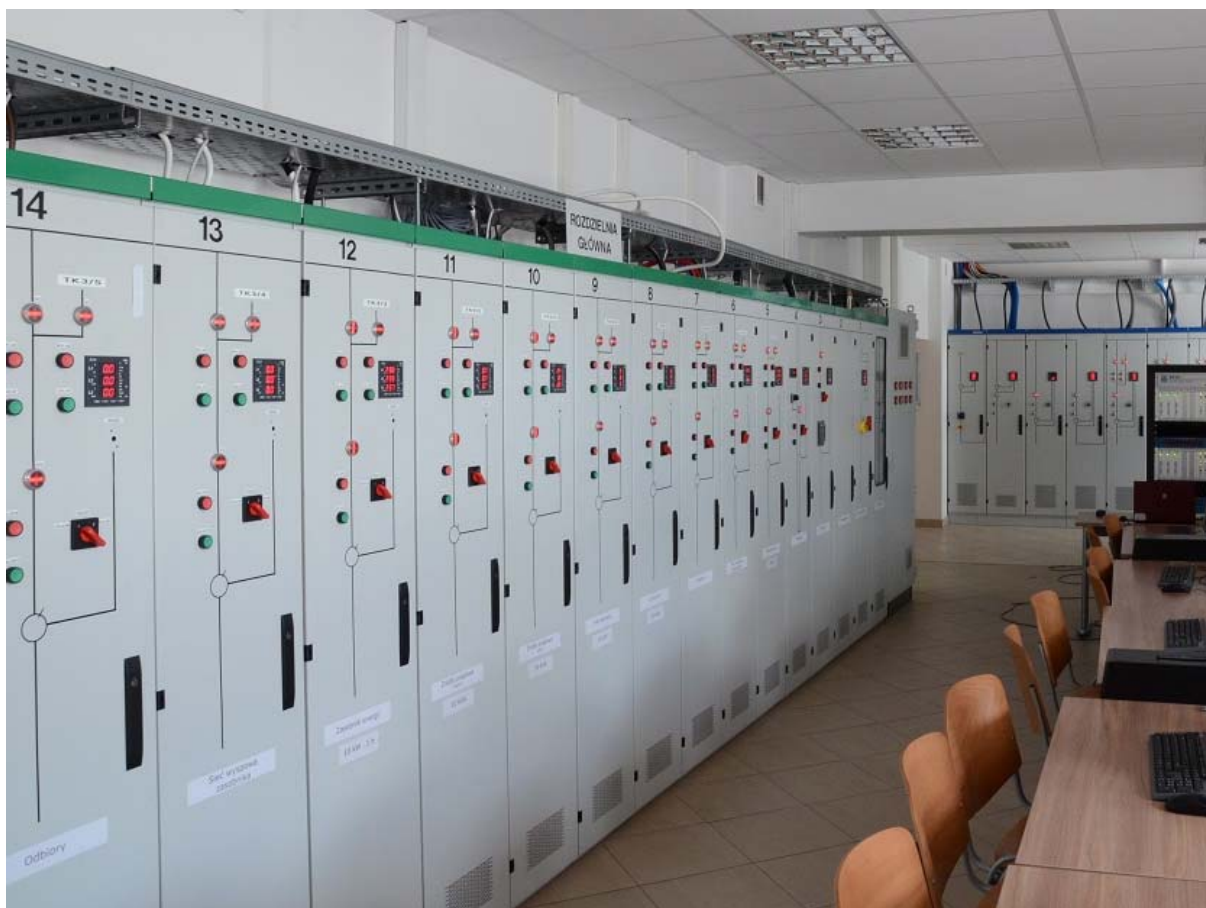
Rys. 2. Rozdzielnice RG1 i RG2 w Laboratorium Generacji Rozproszonej
