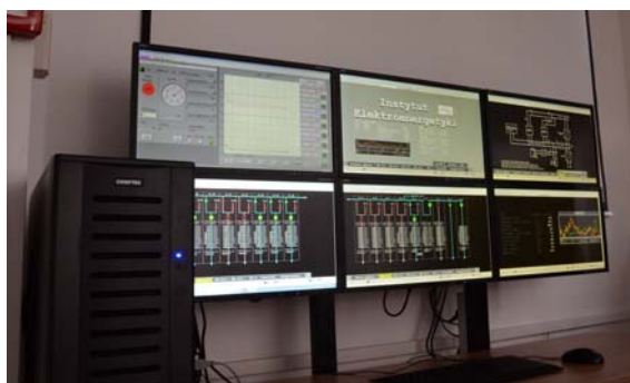
Rys. 6. SCADA BTC Prins stanowisko operatora
